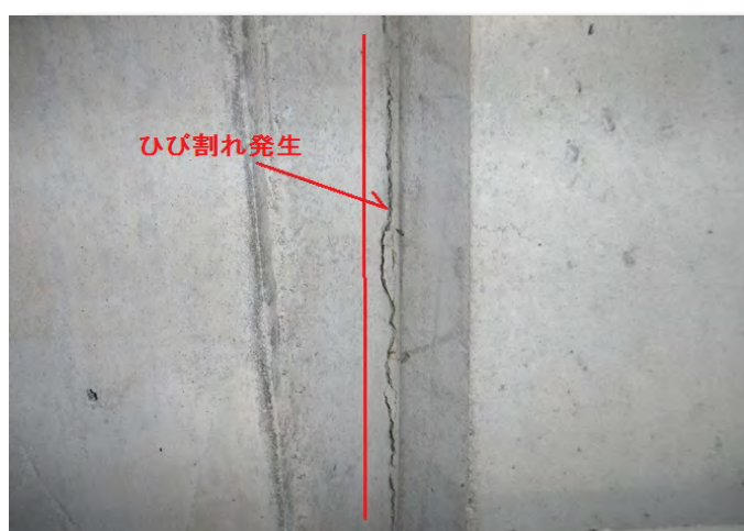
パスキッド塗布なし、ひび割れ発生
