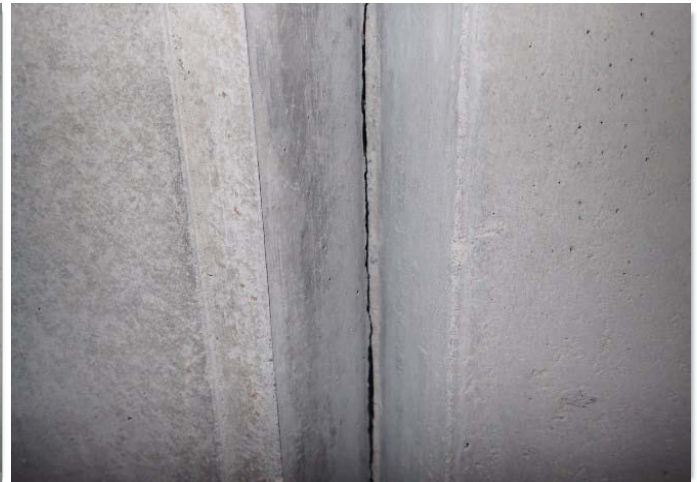
パスキッド塗布あり、ひび割れなし
