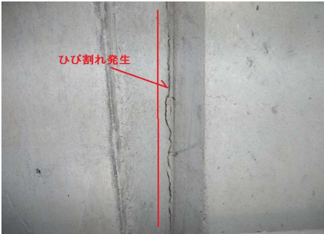
パスキッド塗布なし、ひび割れ発生
